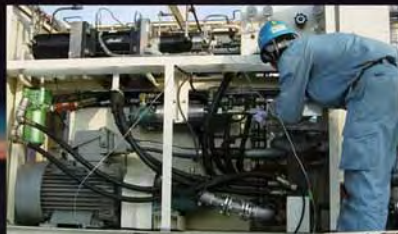
● ガス設備点検
