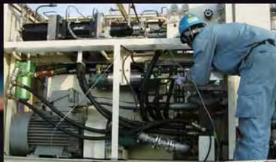
● ガス設備点検
